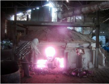
Fig. 1 The door broken open
